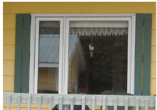
volet trop petit pour la largeur de la fenêtre
